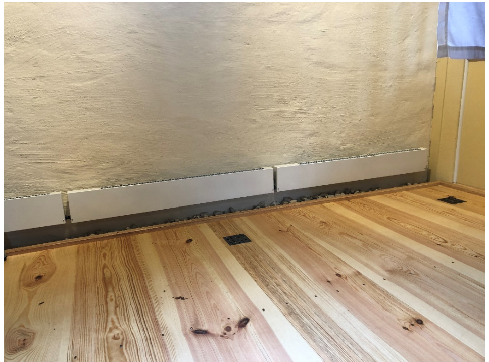
Foto: Heizkörper in Winterkirche, Ragow
